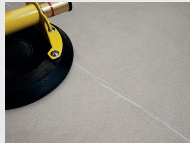
SUCTION CUP DETAIL WITHOUT RIGID FRAME DETALLE DE VENTOSA EXENTA DE BASTIDOR
